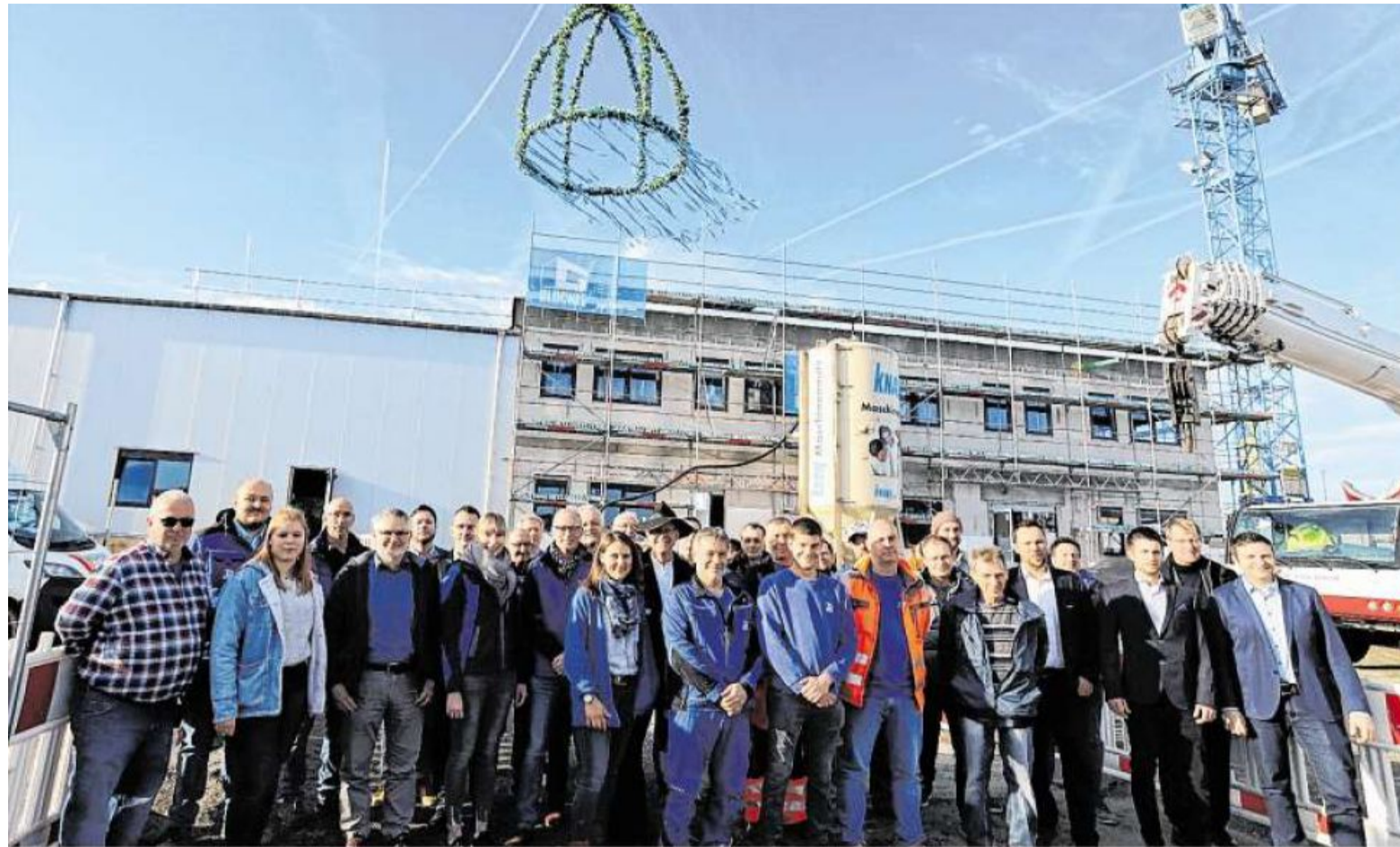
Der Rohbau für die neue Firmenzentrale des bundesweit größten Bosch-Service-Betriebs Mezger im Schweinfurter Gewerbegebiet Hafen steht. Beim Richtfest auf der Großbaustelle an der der Sven-Wingquist-Straße zugegen waren Mitarbeiter des beauftragten Bauunternehmens Glöckle, darunter Geschäftsführer Bernd Supthut (Zweiter von rechts), sowie Mezger-Geschäftsführer Mirko Denzer (rechts). FOTOS: STEFAN PFISTER
